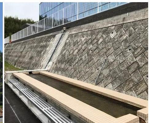
温泉水の貯留槽を兼ねた「天然の足湯」
